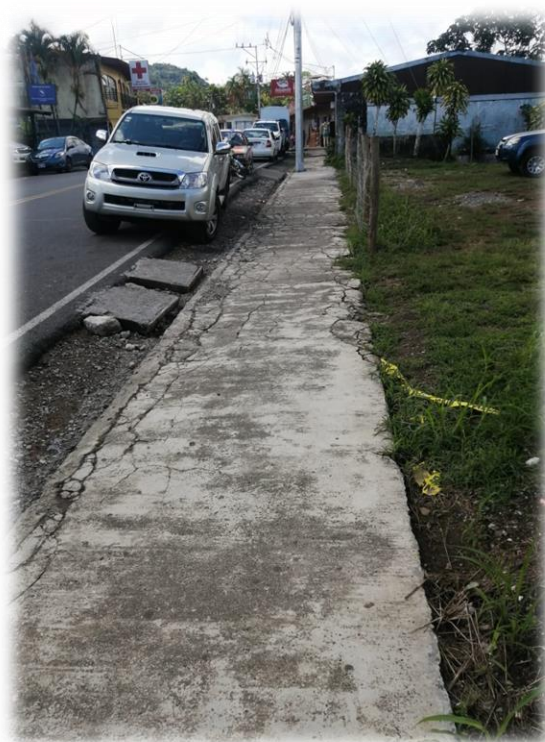
Imagen 22. Acera en mal estado.
