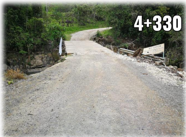
Imagen 3. Barandas de Puente sobre Río Cotón en mal estado.
