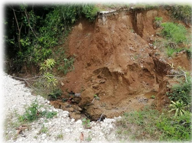
Imagen 9. Hundimiento de la vía Camino El Mondongo.
