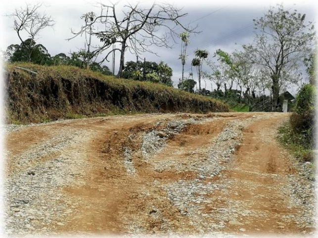
Imagen 16. Estado de Camino La Libertad.
