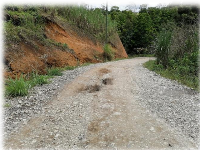
Imagen 20. Estado de Camino La Libertad.
