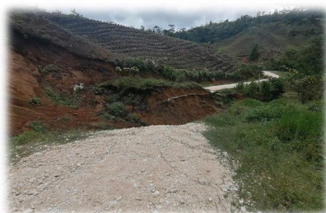
Imagen 15. Hundimiento Camino Valle Azul – San Martín 6-08-325.
