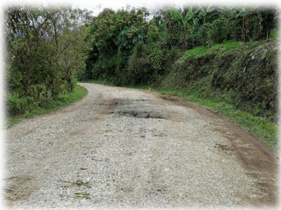
Imagen 18. Estado de Camino La Libertad.
