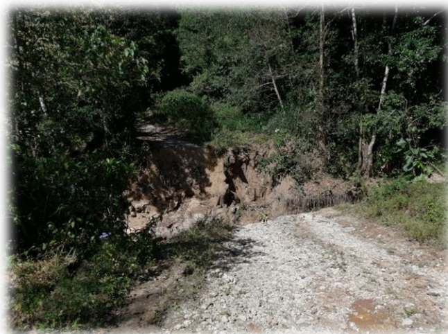
Imagen 11. Hundimiento Camino Mellizas – Los Navarro.
