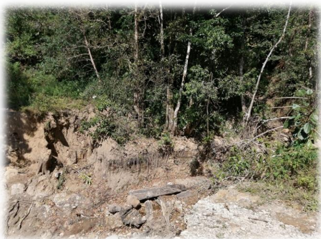
Imagen 10. Hundimiento Camino Mellizas – Los Navarro.
