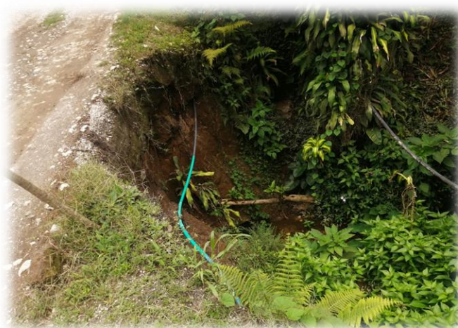
Imagen 13. Socavación de calzada en paso de alcantarilla existente.
