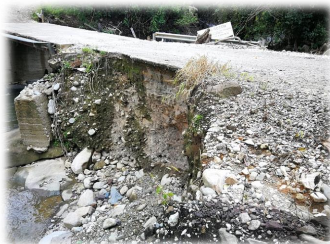
Imagen 2. Socavación de la calzada en aproximación al Puente sobre Río Cotón.
