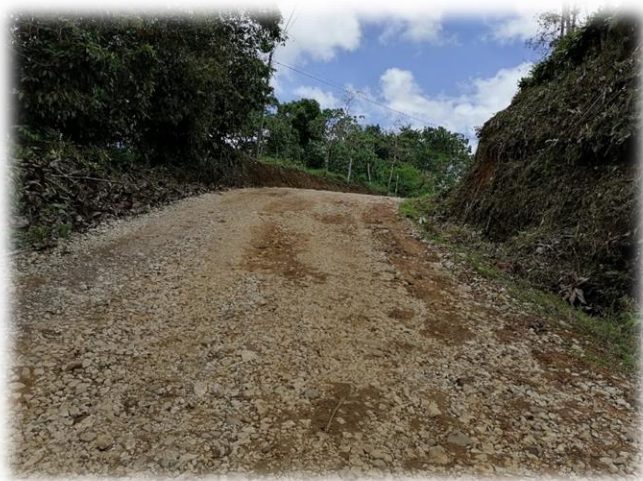
Imagen 19. Estado de Camino La Libertad.
