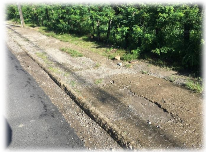
Imagen 21. Aceras en mal estado.
