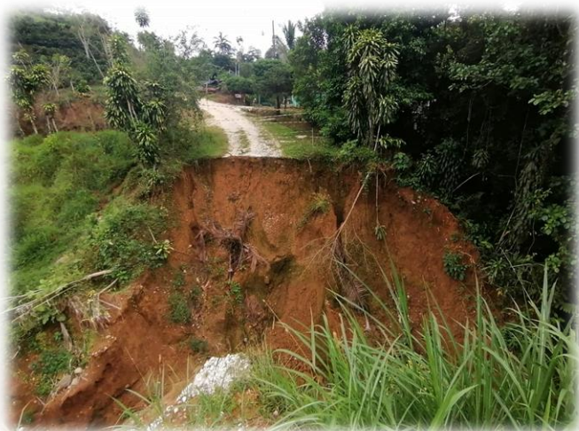
Imagen 8. Hundimiento de la vía Camino El Mondongo.
